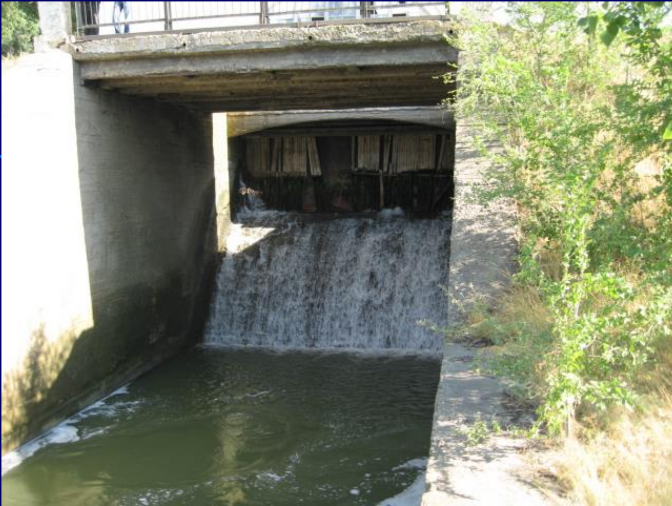
Гидроузел на Садковском сбросе Донского магистрального канала
